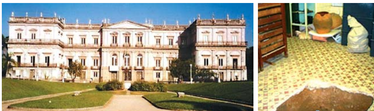
Fig. 1 e 2 – Museu Nacional – Rio de Janeiro – Infiltração e desabamento do piso hidráulico
